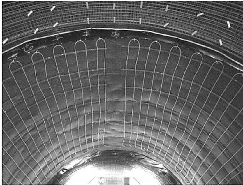
Figuur 102: Absorptieslangen bevestigd aan de buitenbekleding van de tunnel (Buhmann & AI, 2016)
